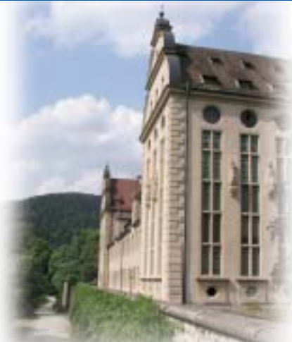
Unter der schönen Fassade bröckelt die alte Kanalisation
